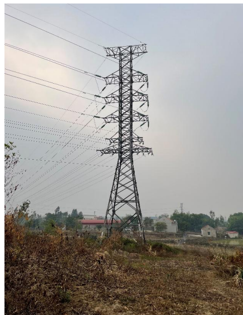
Đường điện trung thế 220KV
